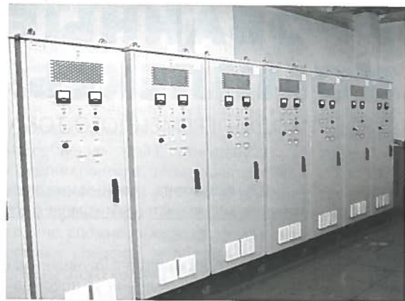
Рис. 3. Частотные преобразователи электроприводов металлургического комплекса
